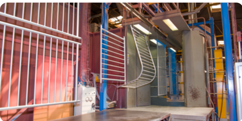
Ligne automatisée de thermolaquage
